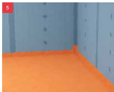
5 Celoplošné utěsnění povrchu v oblasti W1-I.
